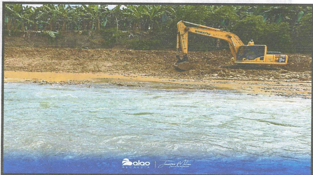
Figura 41 Construcción de muro en el sector Nueva Italia adyacente al puente sobre el Rio Balao, ubicado en la vía panamericana
