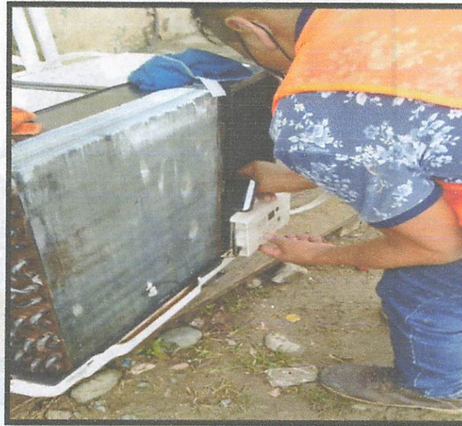
Figura 22 Mantenimiento de Aires Acondicionados
